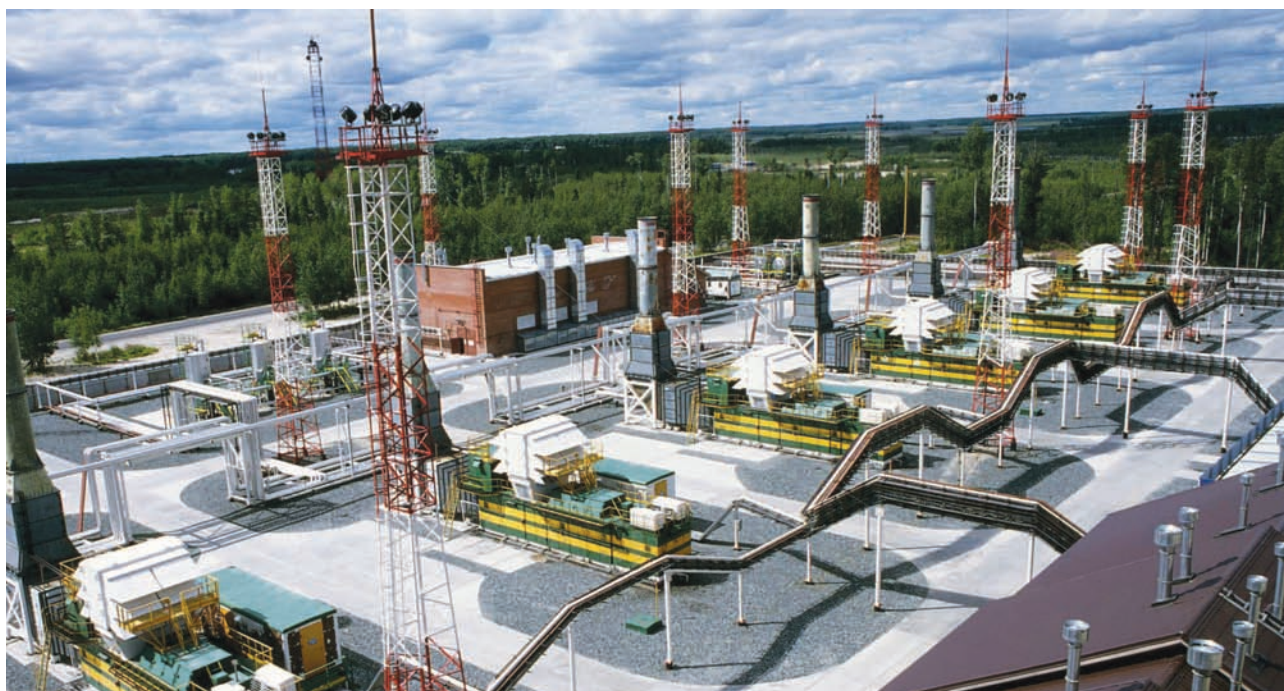
Газотурбинная электростанция мощностью 24 МВт. Проектировщик – ОАО «Гипротюменнефтегаз»
